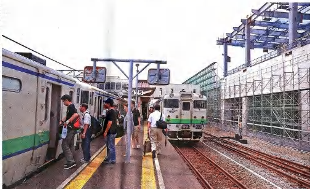
鉄道ファンの姿が目立つ木古内駅。現ホームの隣では北海道新幹線木古内駅の工事が進む
